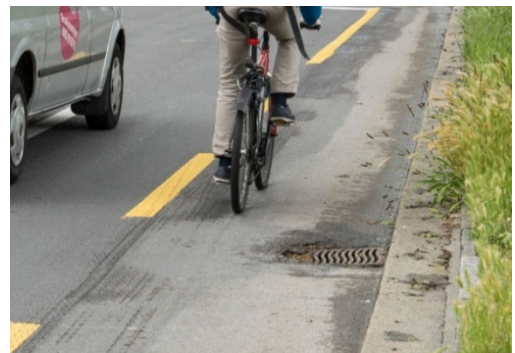
Problematisch: Der Einlauf nimmt vom schmalen Radstreifen eine erhebliche Breite weg; der Deckbelag ist zudem beschädigt. Dies führt zu Ausweichverhalten und zu Sturzgefahr.
