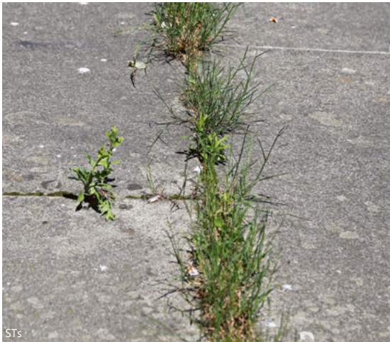
Unverfugte Zwischenräume zwischen Platten bilden Kleinstlebensräume (Galgenfeld)
