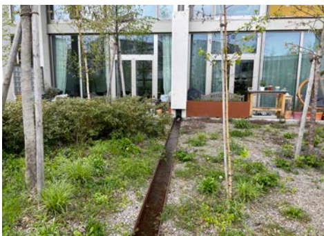
Abb. 43. Fassadenrinne leitet überschüssiges Regenwasser aus Retentionsdach zum Auffangbecken (Zürich, Wolkenwerk, 2)
