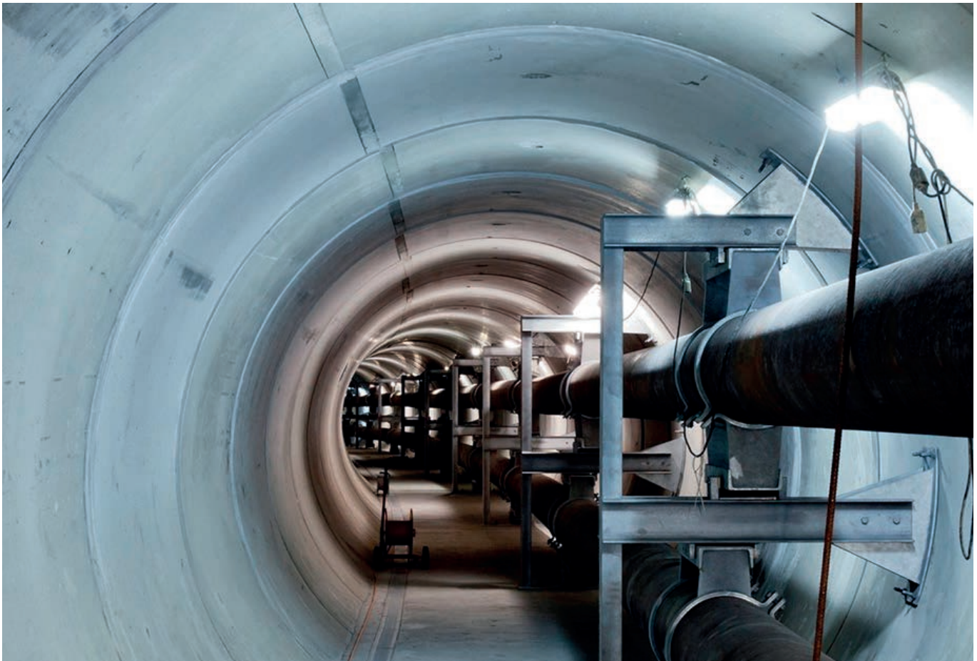
Begehbarer Fernwärme-Kanal von Energie Wasser Bern
