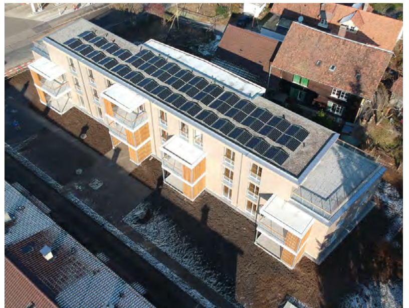
Photovoltaikanlage auf dem Flachdach
