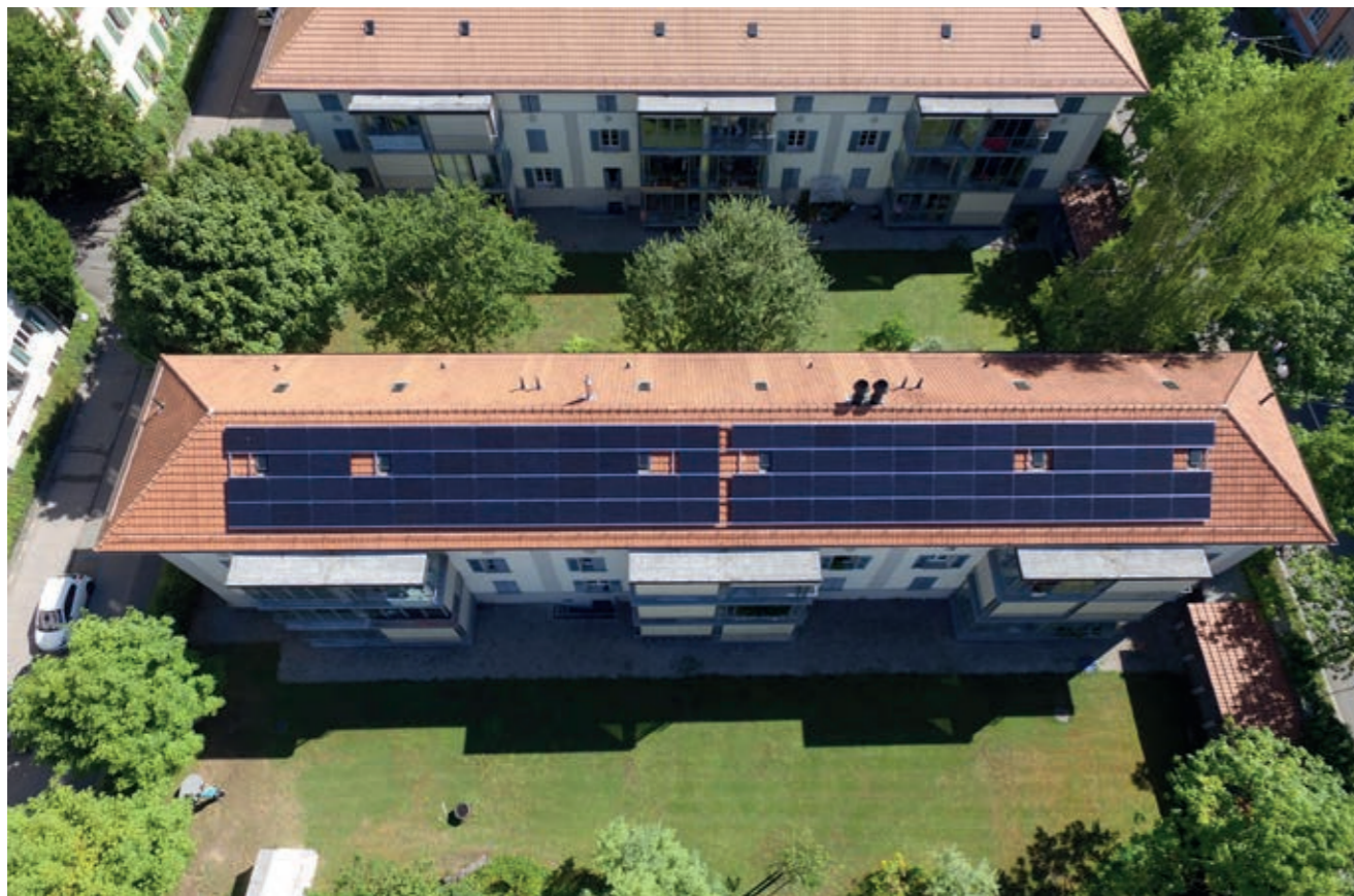
Photovoltaikanlage Verein Sunraising – Mehrfamilienhaus Standstrasse 24, 26, Wylerfeldstrasse 35
