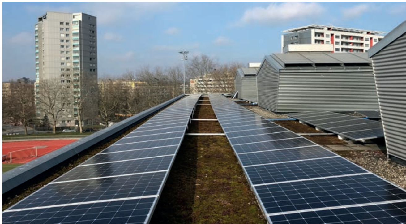
Photovoltaikanlage Solarify GmbH – SP Wankdorf, Papiermühlestrasse 91
