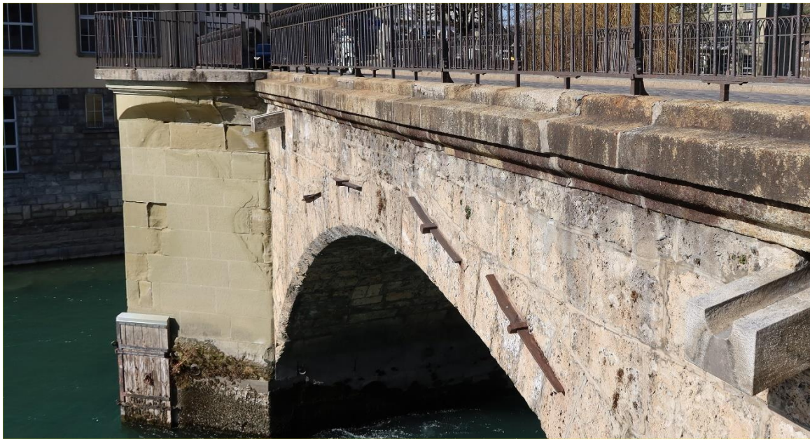
Abb. 5: Schadhafte Mauerwerk, Risse und Ausbrüche der Steine
